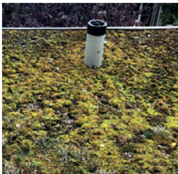
OB45: Flachdach stark vermoost
