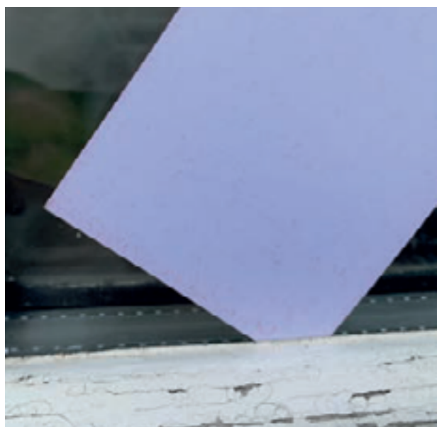
OB28: Undichte Fugen
