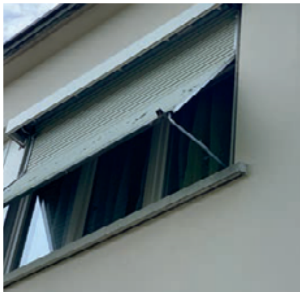
WB47: Rollläden Nordseite
