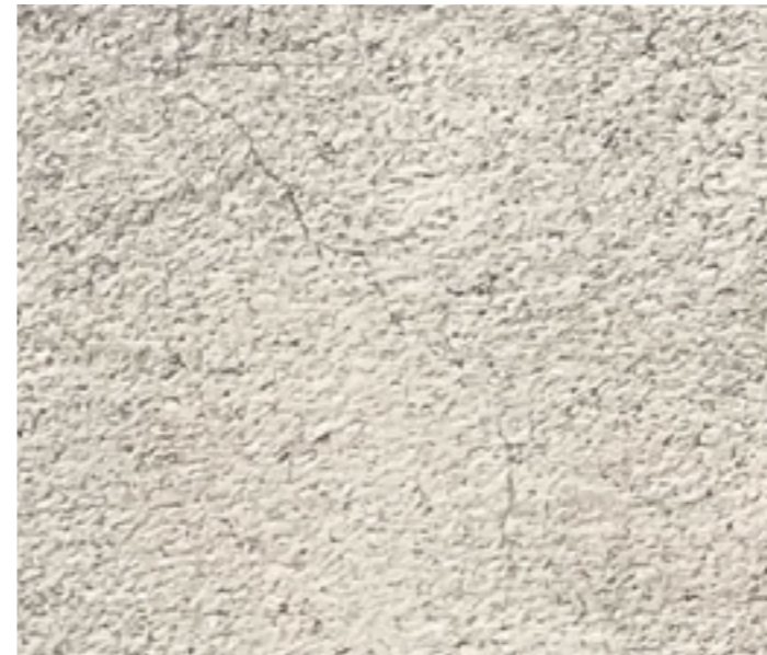
Ostbühlstrasse 27-41, 5mm Putzaufbau, deutliche Verfärbungen
