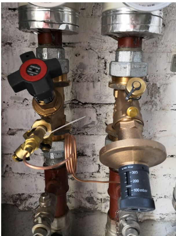
Differenzdruckregler zur Durchflussmengensteuerung
